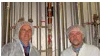
Pārtikas rūpnīcā uzstādīta Vulcan ierīce
